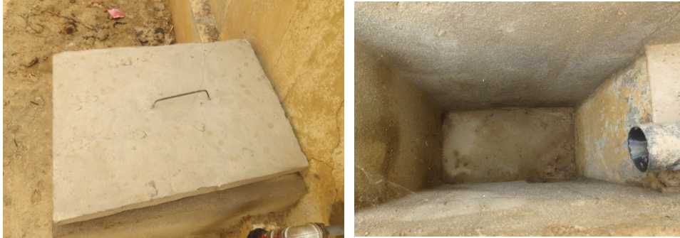
Regards de transit des eaux usées
