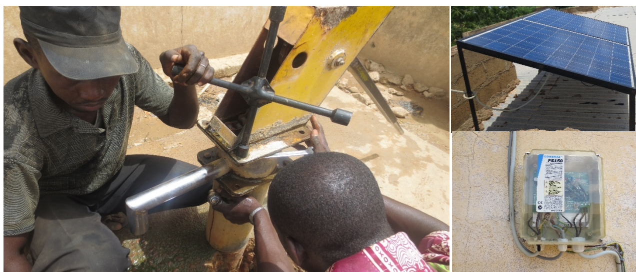
Photo @Tdh Installation pompage solaire sur forage équipé de PMH à Komola-Zanfina.
